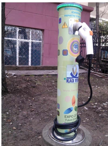
Рисунок 3. Установленная на автостоянке университета зарядная станция для электромобилей
